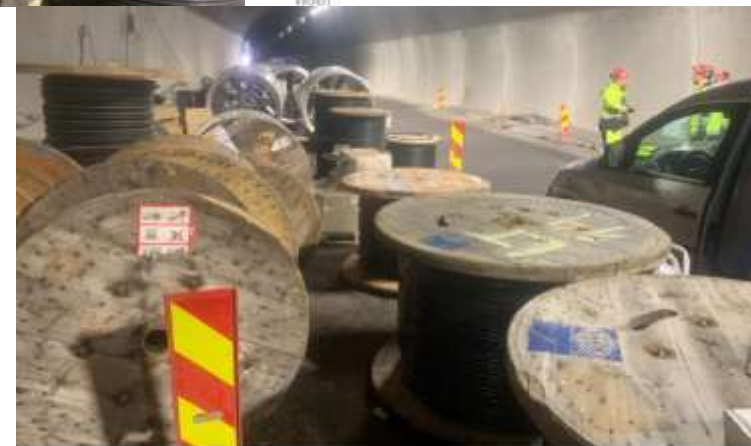
270 kilometer med kabler skal sørge for trygg stromforsyning til det nye veianlegget over Sollihøgda. (Foto: Hjel West)
